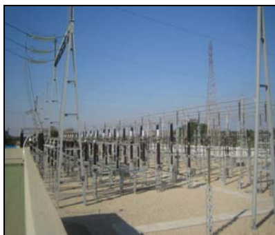
Poste de transformation
